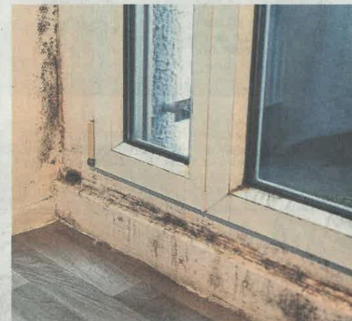
De la moisissure sur un mur lors d'une visite d'appartement. Photo Roméo Boetzlé
